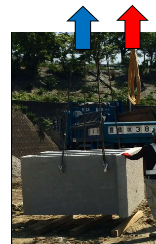
補巻フックを巻き上げ、吊りマスターのロックを再確認し、主巻フックで据付を行う。
