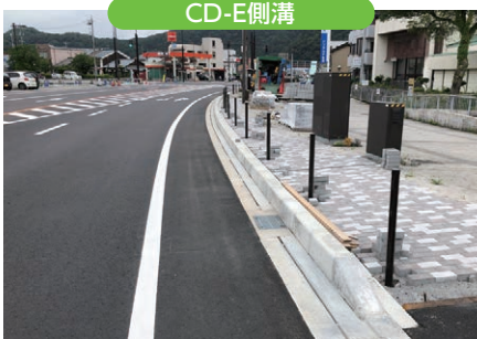
福井河川国道事務所：国道8号元町地区・本町地区 敦賀市
