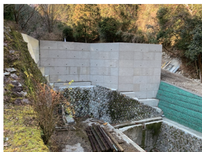
中部電力：下原(発) 麻生谷 下呂市
